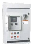
Электрические шкафы гидравлических насосов
